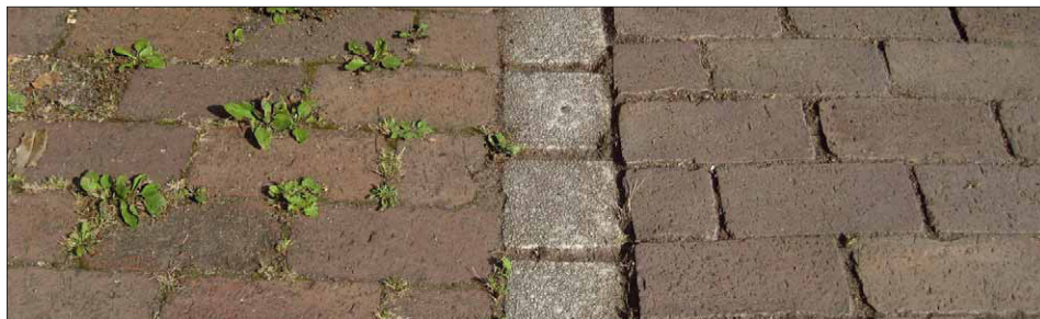
Hier erkennt man gut, dass die Kanten der Pflastersteine nicht angegriffen werden
